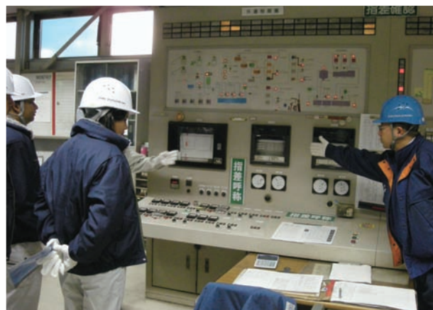
施設見学（中央操作室）
